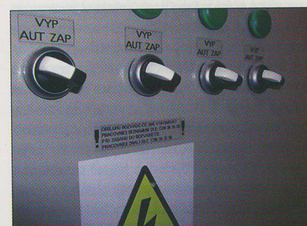
Obr. 3: Varovný popis na rozvaděči
