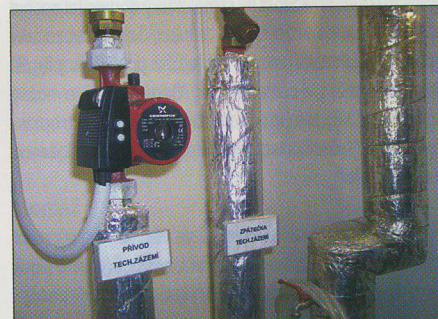
Obr. 2: Štítky na rozvodech medií
