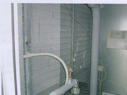
Obr. 9 Nevhodná montáž kapilár
