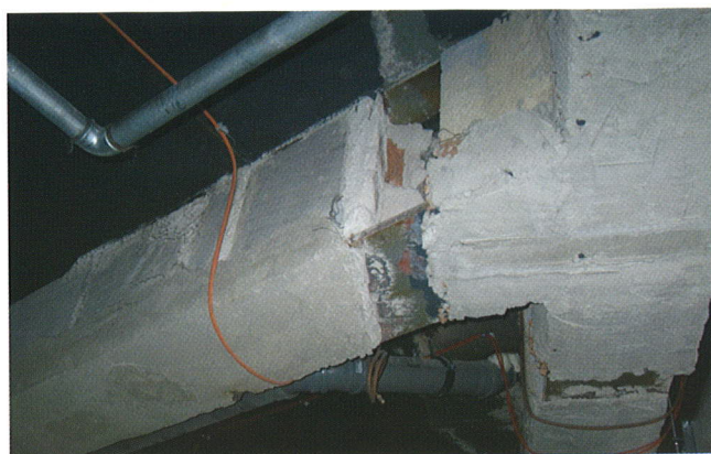
Obr. 2 – Staré VZT potrubí
