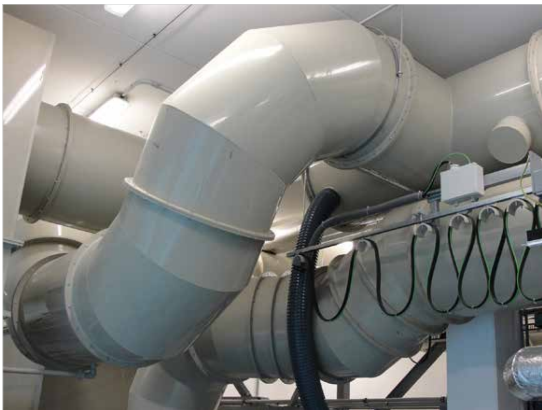
Významnou součástí uceleného vzduchotechnického systému z plastů, který také profiluje firmu FORT - PLASTY, tvoří potrubí nejrůznějších tvarů a velikostí
